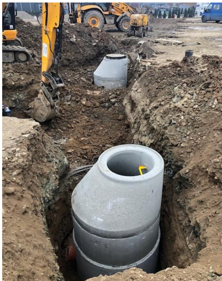
Zdjęcie nr 11 „Rozbudowa sieci kanalizacyjnej w m. Podrzecze Przysiółek Tłoki w systemie zaprojektuj, wybuduj”.
